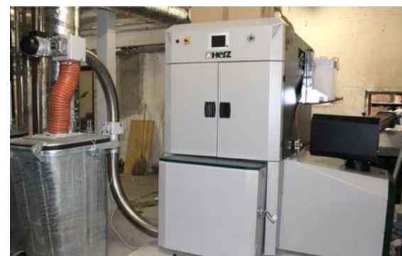
Nuova caldaia a cippato
